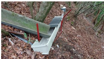
排水路の要改良箇所
