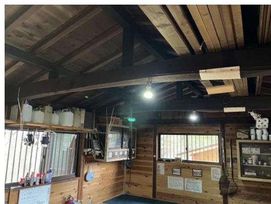
小屋内部 (点灯確認)
