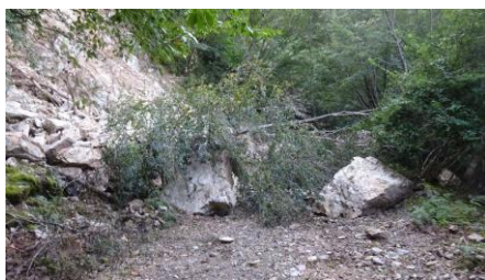
崩落直後の林道
